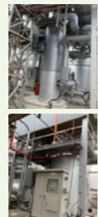
不飽和設備更新ボイラーおよび30系設備更新ボイラー
